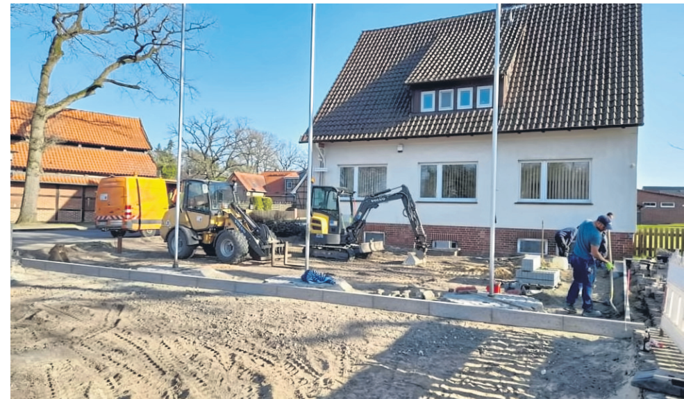
Die Arbeiten zur Umgestaltung des Platzes haben bereits begonnen und sollen Ende des Monats abgeschlossen sein.
